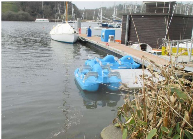
Station « Bateau Propre » et pompes associées sur ponton G
