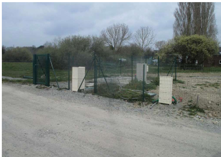
Poste de relevage EU déplacé en dehors du terre plein au Nord Est du chantier naval
