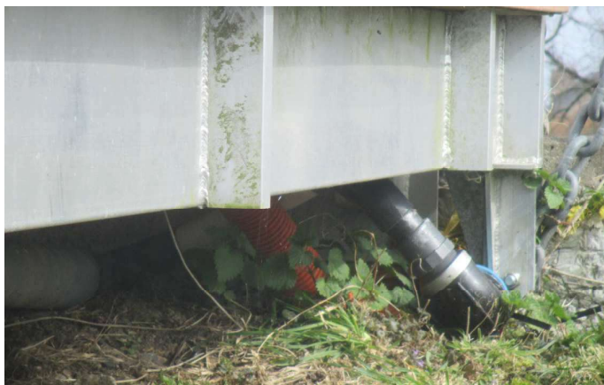
Canalisation de la station « Bateau Propre »
