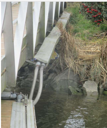
Canalisations station « Bateau Propre » et carburant dans galerie technique
