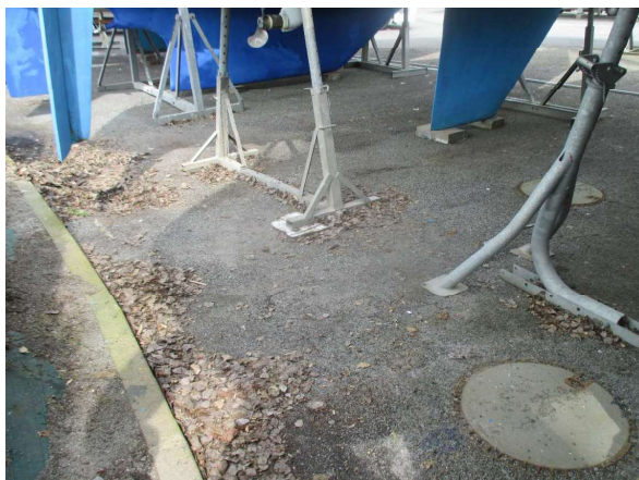
Regard de collecte des eaux pluviales de la plateforme technique
