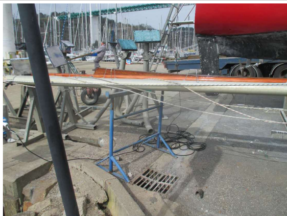
Regard de collecte des eaux pluviales de l'aire de levage
