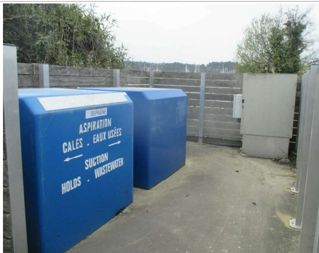
Pompes de la station « Bateau Propre » devant passerelle Ponton A
