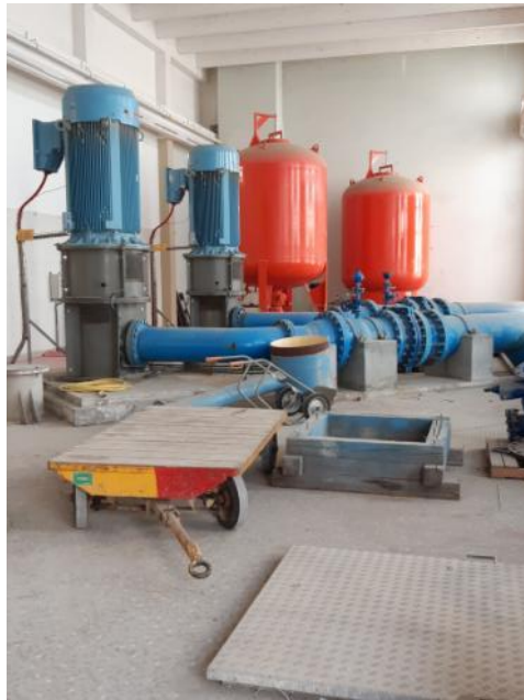
Illustration n°6 : vue des pompes de reprise de l'eau traitée dans les nouvelles installations.
